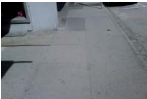
Abbildung 181 oben: Ist-Zustand noch ohne gestalterische Maßnahme; hier ist Handlungsbedarf Quelle: D I S
