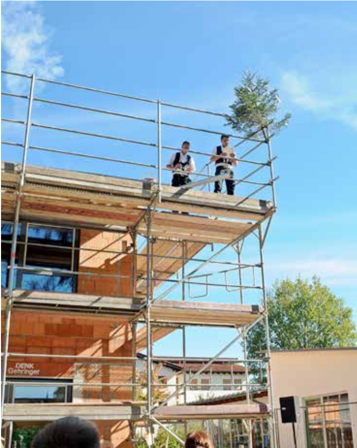
Der Richtspruch wurde von Michael Tröstl von der Firma Holzbau Tröstl vorgetragen. Fotos: Stadt Altötting
