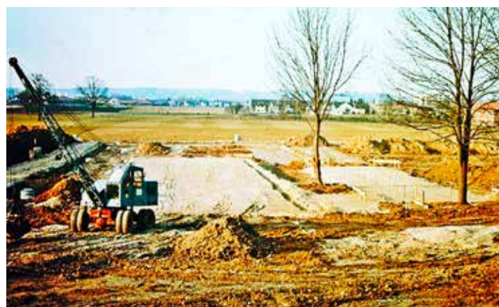
Die Baustelle, an das heutige Freibad St. Georgen von vielen Bürgern genutzt wird.
