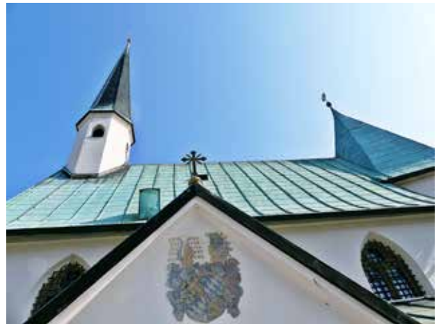
Das Dach der Südseite der Gnadenkapelle ist während eines Sturmes ausgehoben worden. Bislang war es immer sehr wettergeschützt.
