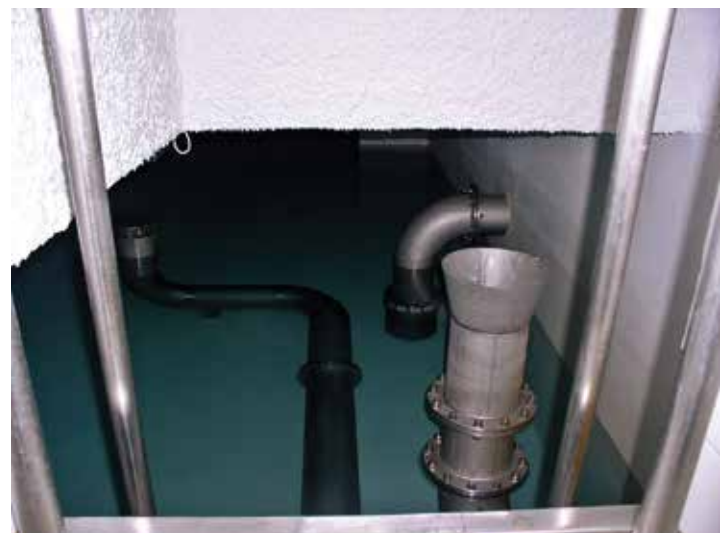
In diesem Becken ruht das von Eisen befreite Wasser, um den überschüssigen Sauerstoff abgeben zu können.
